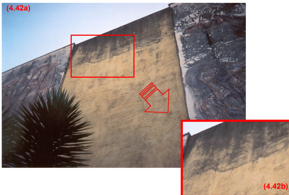
Fotografia 4.42a e 4.42b – Trincas provocadas por movimentações estruturais devidas aos gradientes de temperatura (Pró-Reitoria de Assuntos da Comunidade Universitária).
