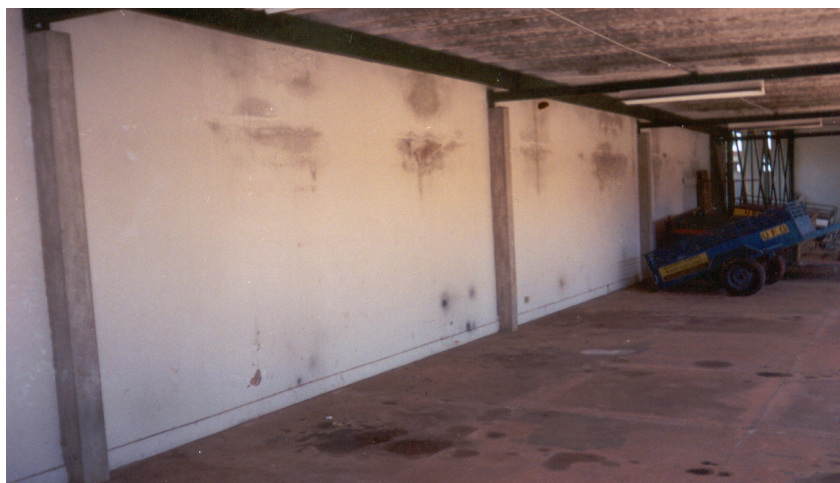
Fotografia 4.8 – Manchas de umidade decorrentes de infiltrações através de trincas ou fissuras, verificadas do Serviço de Transportes (ST).
