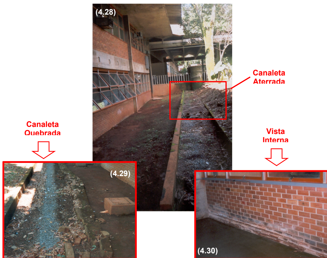
Fotografias 4.28, 4.29 e 4.30 – Causas imediatas mais prováveis: Falta ou falha em drenagens adjacentes (Instituto de Física)
