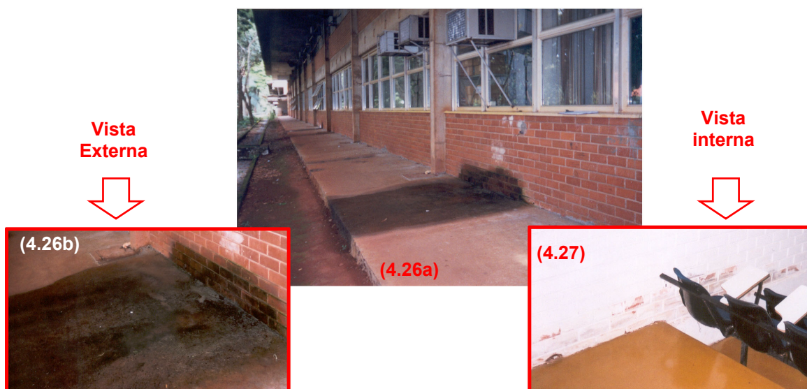
Fotografias 4.26a, 4.26b e 4.27 – Falta ou Falha na coleta e encaminhamento da água dos aparelhos condicionadores de ar, localizados no prédio do Instituto de Ciências Biológicas II (ICB II), constituindo-se em causa mais provável da deterioração. As fotografias 4.26b e 4.27 são faces adjacentes (externa e interna) de uma mesma parede.
