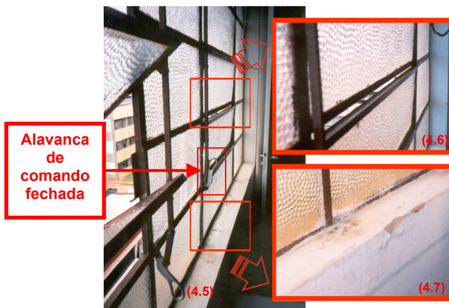
Fotografias 4.5, 4.6 e 4.7 – Ilustração de problema patológico provocado por falta ou falha em estanqueidade de esquadrias (4.5 e 4.6) e em peitoris (4.7), encontrados no prédio do Museu Antropológico (MA).
