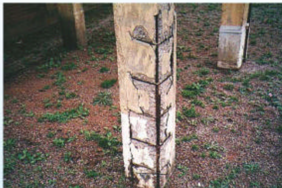
Corrosão de armaduras
