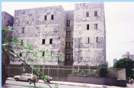
Fissuras em fachadas
