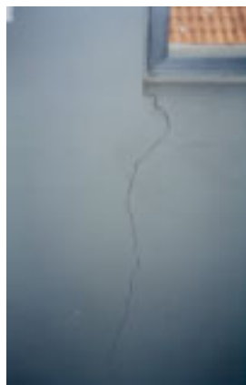
Fissura sob esquadria
