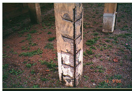
Corrosão de armaduras
