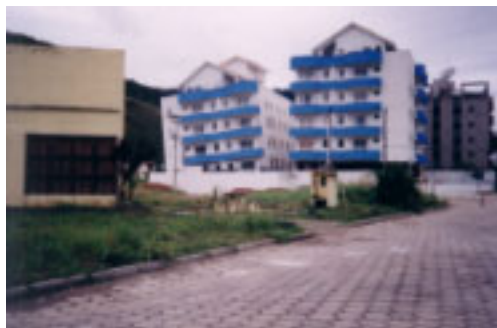
Recalque diferenciado nas fundações
