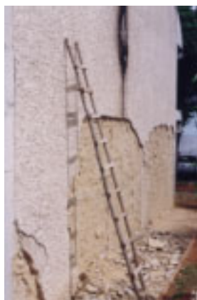
Problema de aderência de argamassa
