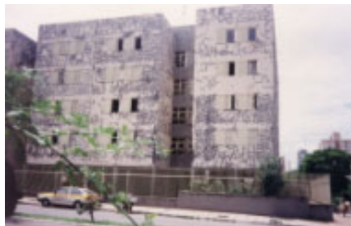
Fissuração de argamassa nas fachadas
